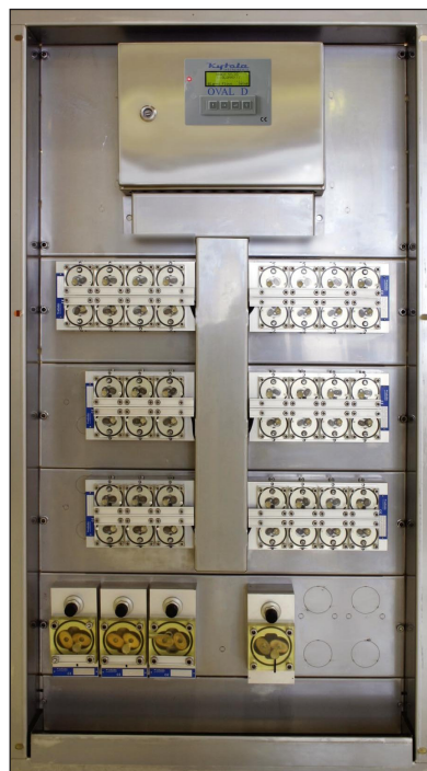
Mätartavla Metering panel
